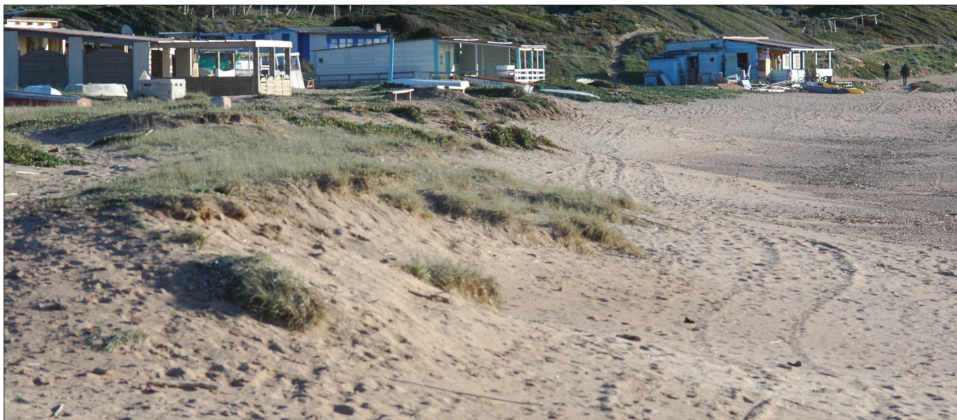
Photo 14. Cabanons les plus au sud et érosion de la basse terrasse, 5 février 2011.
